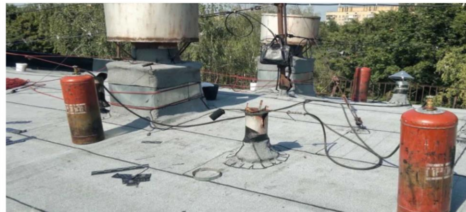
Не допускается хранение газовых баллонов
